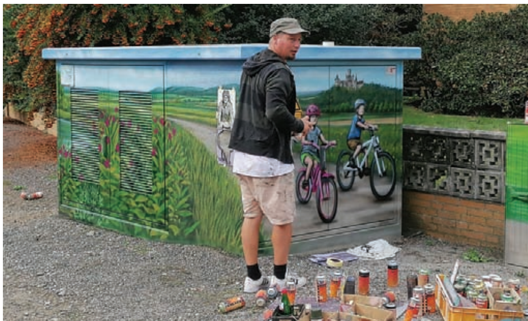
Graffiti-Künstler Ole Goergens vollendet sein Werk am Trafokasten an der Straße An der Masch in Jeinsen. Das Ergebnis kann sich sehen lassen.
